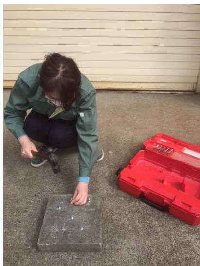
加工実習：コンクリート材へのアンカー基礎ボルト埋め込み
